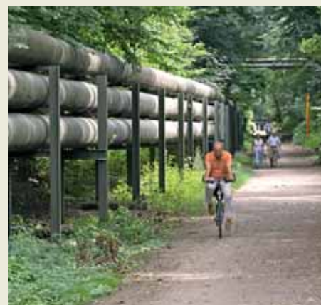
12 Fernwärmerohre prägen seit vielen Jahrzehnten das Gesicht des Reviers. Die von ihnen transportierte Energie aber ist heute aktueller denn je.
