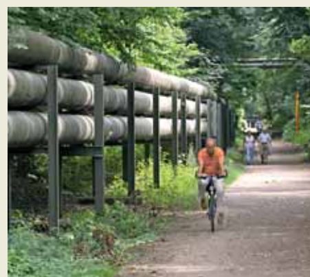
12 Fernwärmerohre prägen seit vielen Jahrzehnten das Gesicht des Reviers. Die von ihnen transportierte Energie aber ist heute aktueller denn je.
