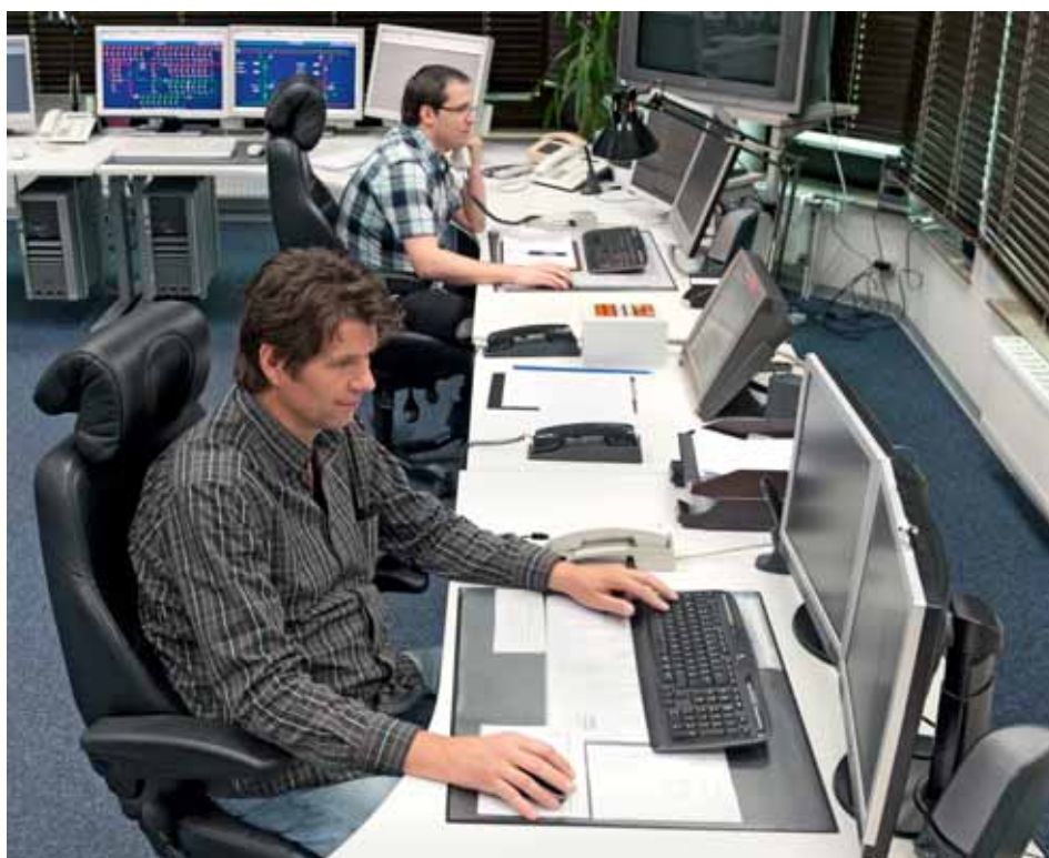
Herz der Versorgung: In der frisch modernisierten Netzleitstelle der Stadtwerke Herne wachen Peter Spiegel (vorn) und Thomas Beyer über den Stromfluss.
